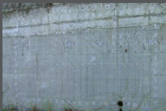
実構造物の打音検査(×印は異常と判断された箇所)
